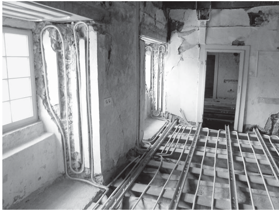
Heizschlangen in den Wänden als Barriere gegen die Feuchtigkeit
