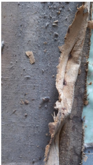
Schäden an der Leinwand.
